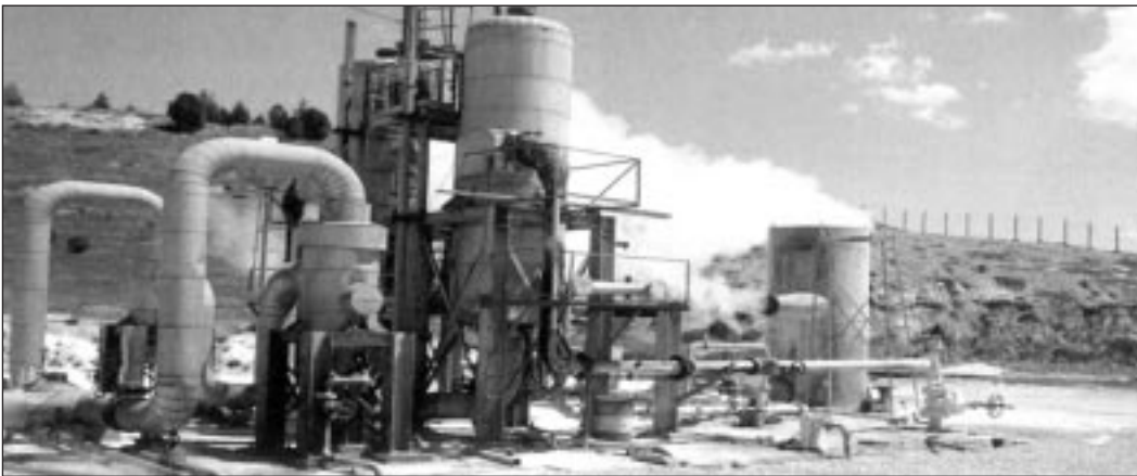
2. kép: Törökországban működő 20 MW-os geotermikus erőmű szeparátor és hűtőtartály
